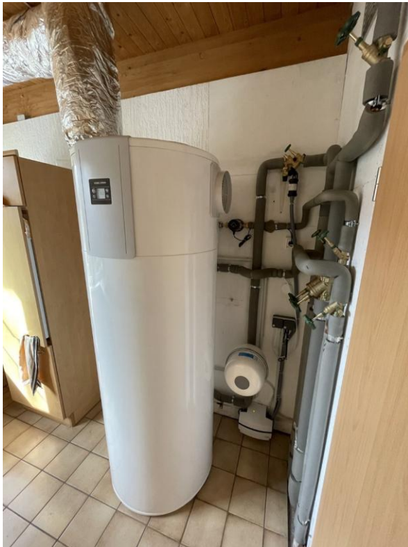
Neue nachhaltige Warmwasserbereitung durch eine Luft-Wärme-Pumpe
